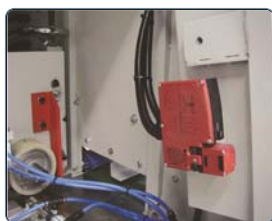
Interrupteur de sécurité à l'intérieur du cabinet
